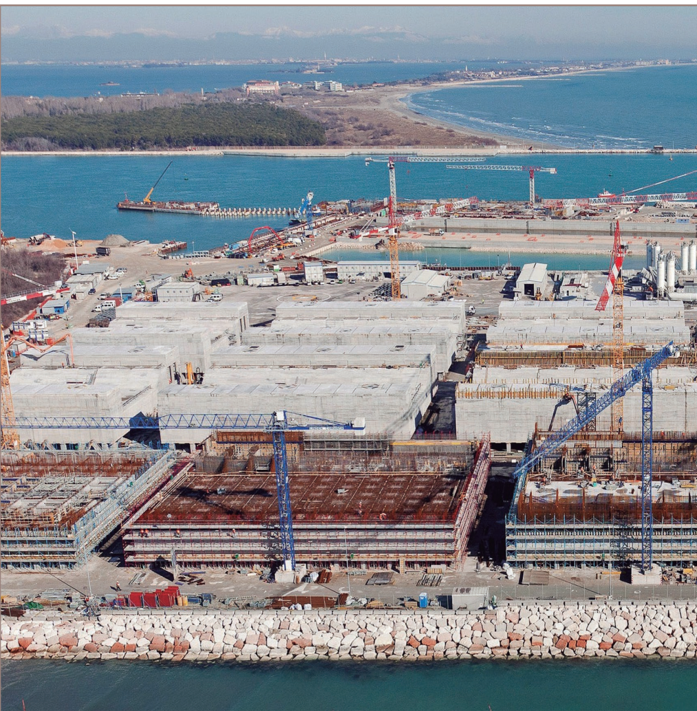
➤ Construcción de las estructuras cajón que soportan las compuertas de acero. CORTESÍA COMANSA
