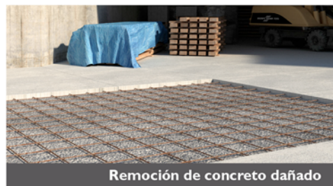
Piso de concreto dañado
