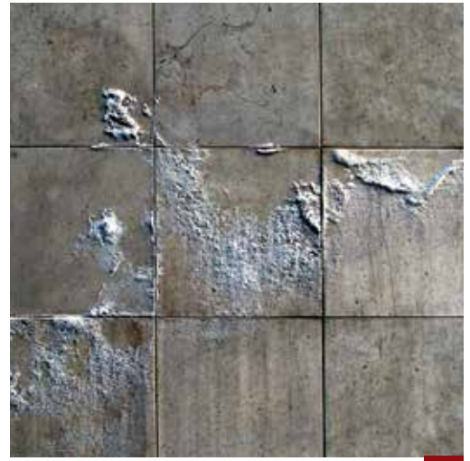
Eflorescencias en superficies de concreto.
