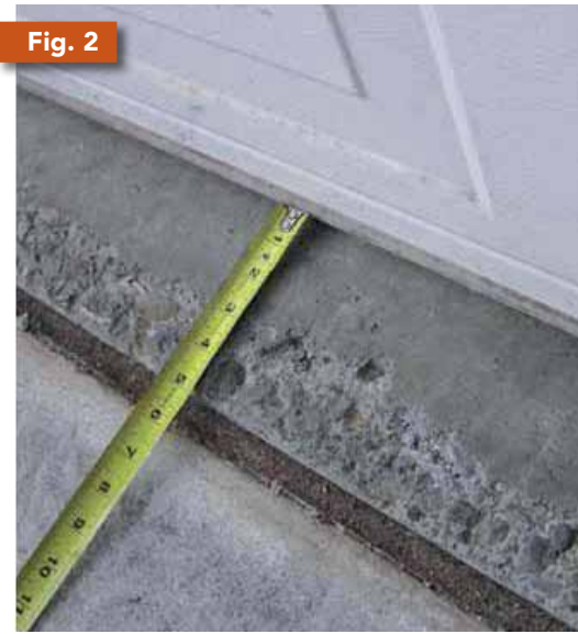
PSA en losa de piso por carbonato de sodio.
