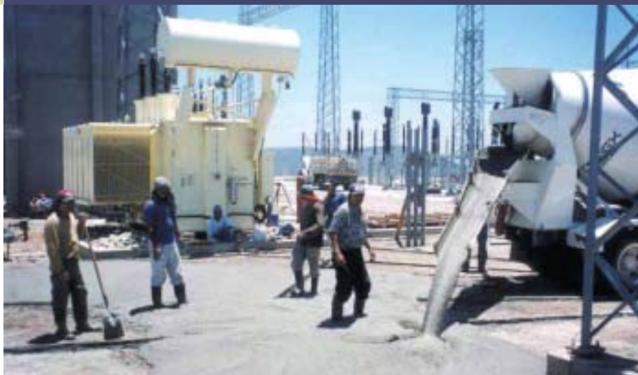
Base subestación eléctrica, Tijuana, BCN
