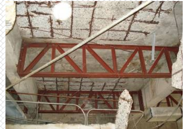
Daño e intemperismo en losas
