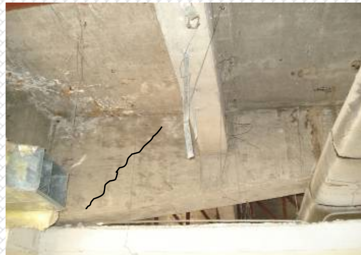
Daño en traves
